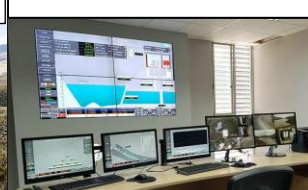
Centro de control de la presa
