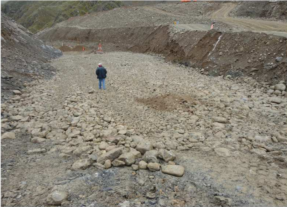
Material 3D de regularización, aguas abajo eje del Plinto. 24-02-2012, Lado Estribo Izquierdo
