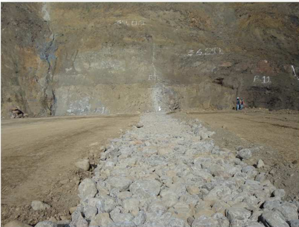
Material drenante 3D, última capa de la zona de estrangulación en la cota 3680.20
